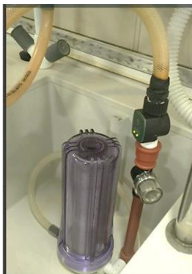
MicroFiltro conectado al sistema de bombeo continuo de circulación de agua de mar del buque.
